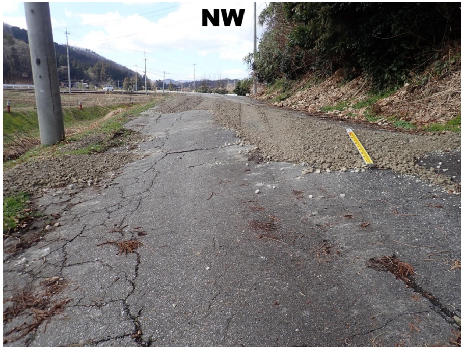
図 12 アスファルト舗装道路の段差（地点 5）。段差は砂利で応急処置されている。北西に向かって撮影。（若山町延武）
