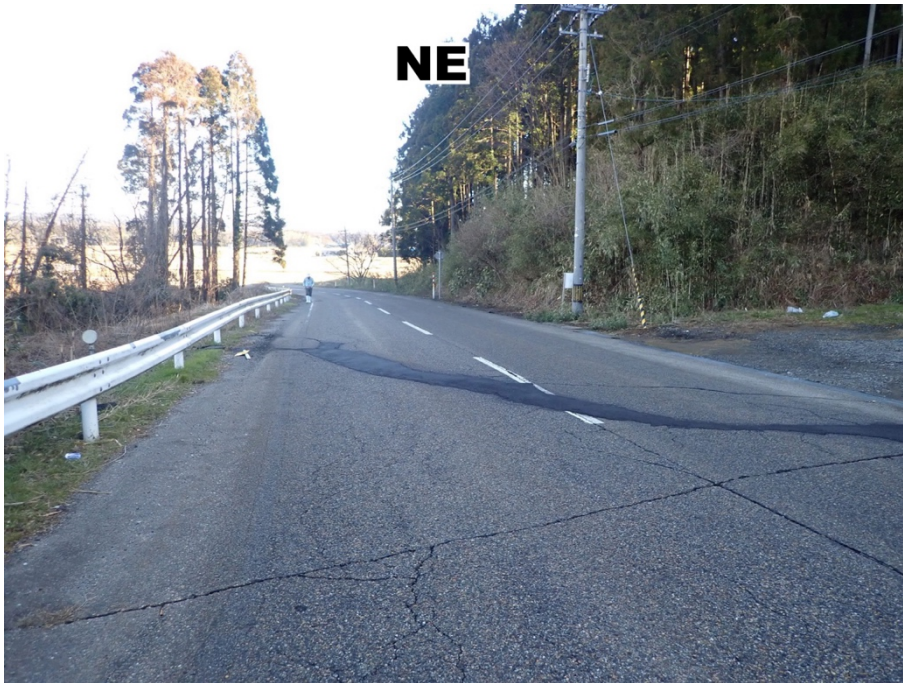
図 14 地山（右手奥）と盛土（左手前）の境界部に生じた右ずれ・西側低下を示す亀裂。人物付近には鈴木・渡辺（2024）で報告された左ずれの亀裂がある。北東に向かって撮影。（志賀町富来地頭町甲、大坂山トンネル出口より約 100 m 北）
