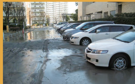
噴砂の状況 (平成23年(2011年)東北地方太平洋沖地震) (千葉県浦安市富岡エステート住宅管理組合自主防災隊提供)
