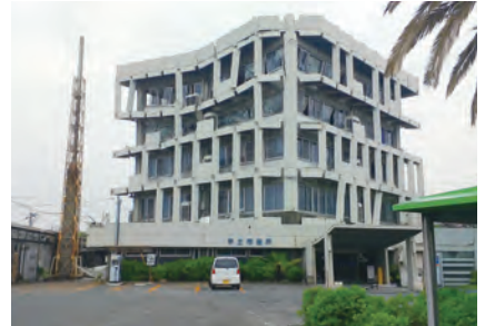
宇土市役所の損壊(平成28年(2016年)熊本地震) (気象庁提供)
