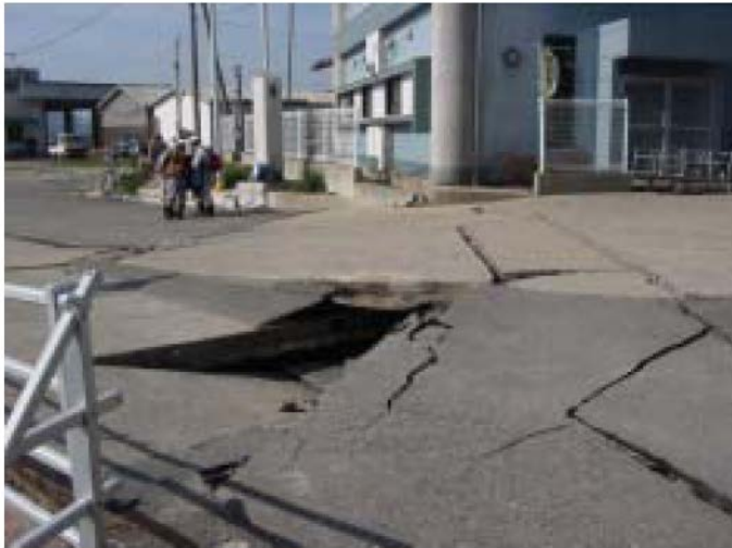
図 9-18 福岡県西方沖の地震で生じた岸壁の亀裂や陥没（福岡市玄海島）〔気象庁（2005）より〕
