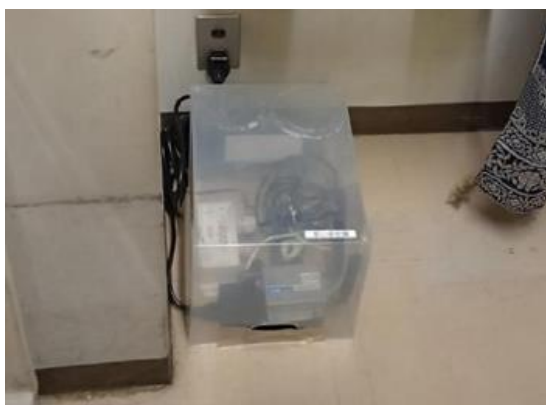
図 2 - 5 - ② - 6 観測装置一式設置状況 (RC 造 1 階床)
