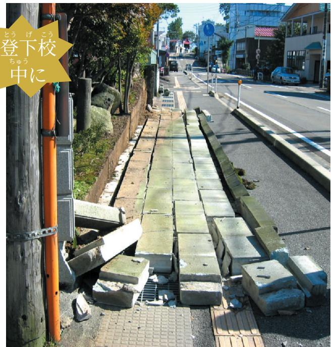
▲地震で倒れたブロック塀 ：新潟県中越地震／平成 16年（2004年） ＊写真提供：東北大学災害制御研究センター
